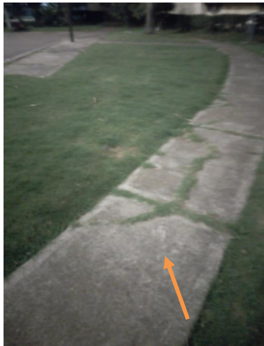
(Sendero agrietado por el cesped)
