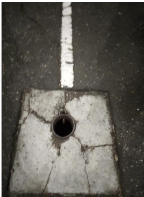
(Anclaje para postes de la red para vóley Sobresaliendo y mal cimentados)
