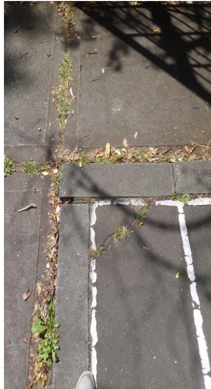
(Agrietamiento de la capa asfáltica)
